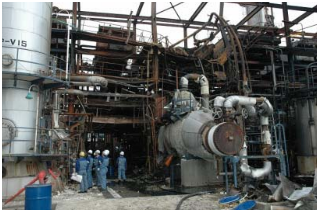
写真2 事故後の状況(通路を挟んで右手は減圧軽油脱硫装置群)
