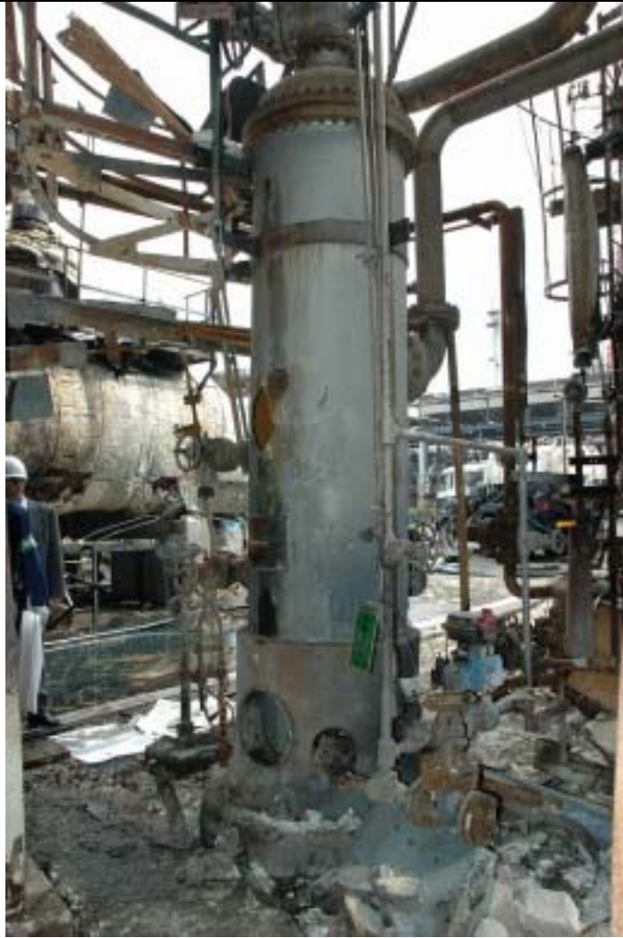
写真3 開口したセパレータの状況
