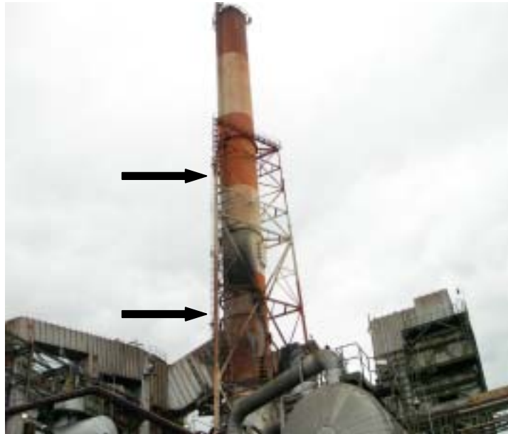
発災した大気放出配管(上部) (煙突に沿って設置されている)
