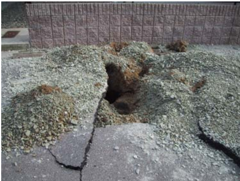
写真2 道路の損傷状況
