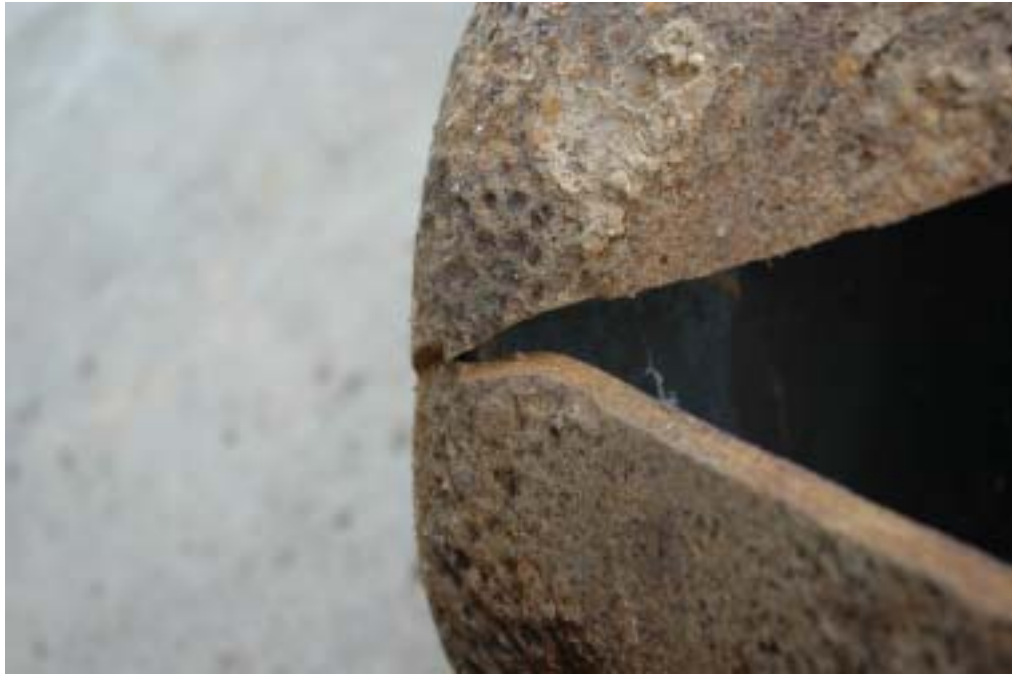
写真 4 容器底部の腐食と割れの状況
