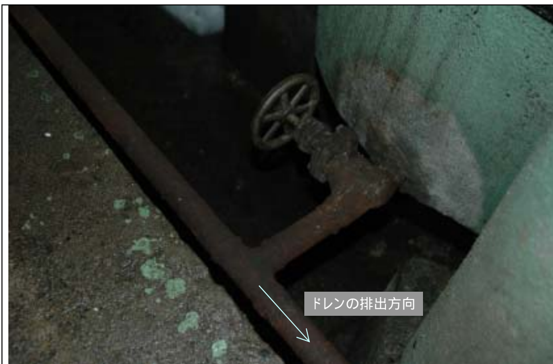
写真1 180度近く開いていたドレン弁
