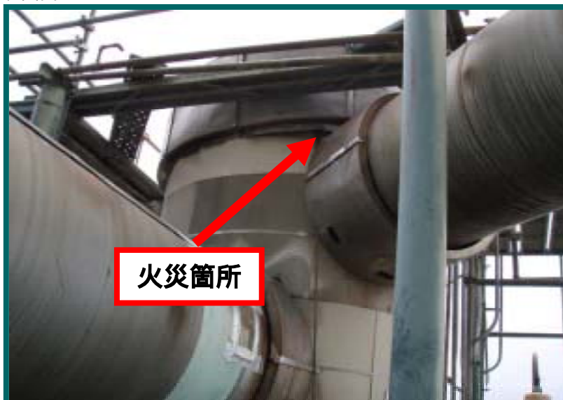
写真 1 火災発生箇所
