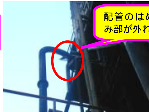
写真2 安全弁放出管(B)(はめ込み部分)
