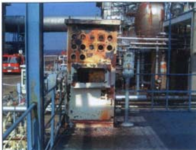
写真1 火災後の現場監視盤
