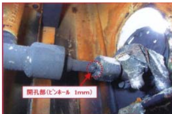
写真2 ピンホールの発生した圧力計取り付けジョイント部
