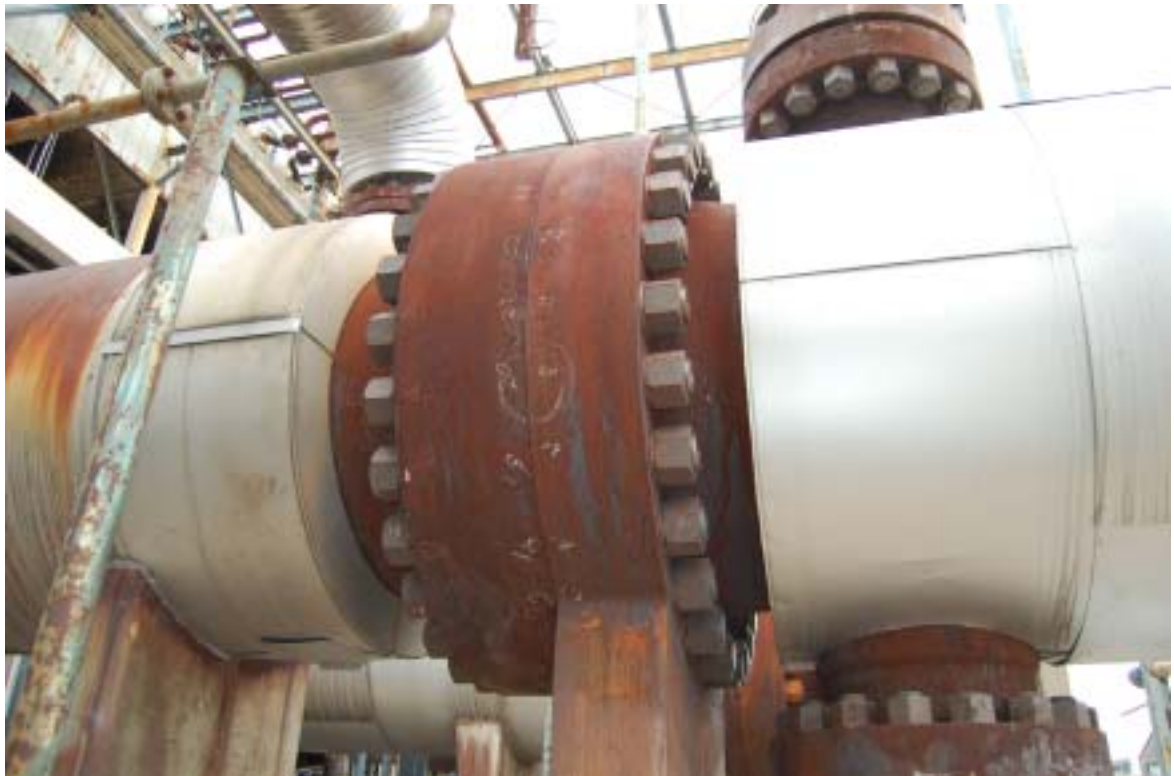
写真1 発災した熱交換器のチャンネルフランジ(現状)
