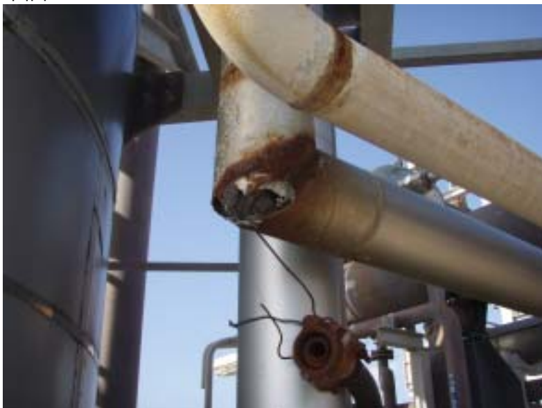
写真1 エルボ部の状況(ガス検実施のため、一部板金を撤去後)
