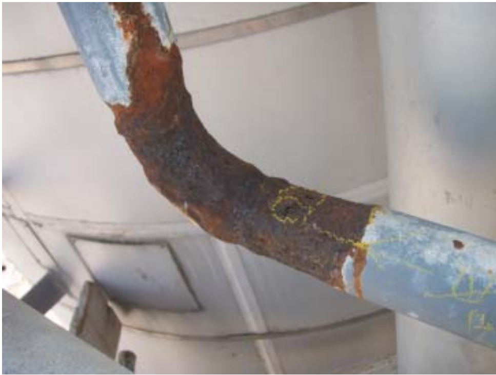
写真 2 保温材を外したエルボの状況
