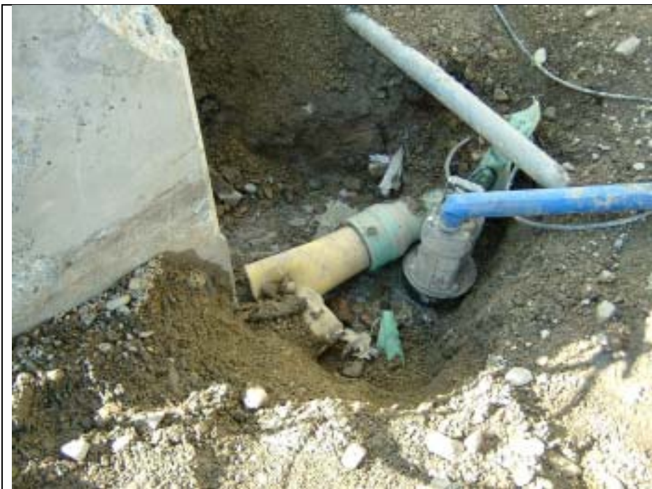
写真1 切断された埋設管の状況
