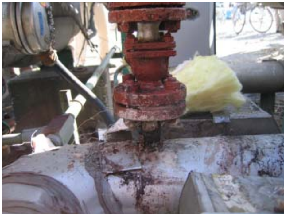
写真1 漏えい後の状況
