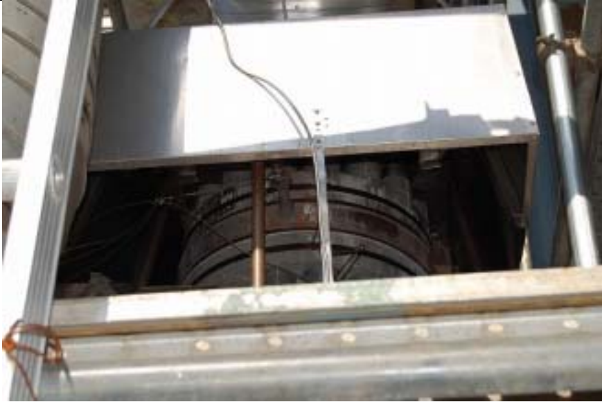
写真4 ウェザーシールとフランジ(現状)
