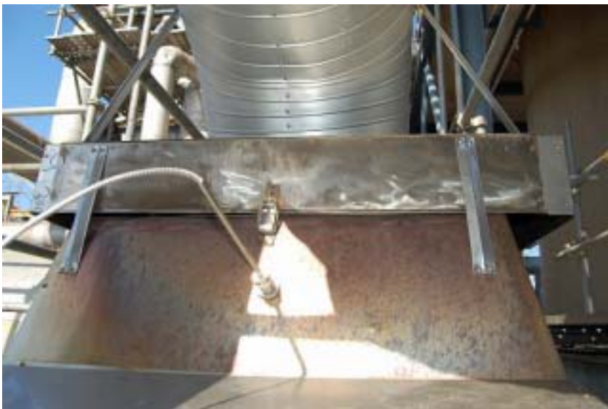
写真 2 出口ノズルに取り付けた状況(現状)
