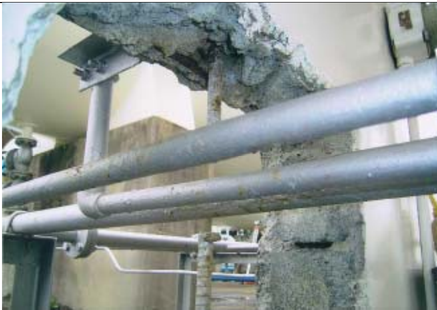
写真1 腐食した配管(当初は、コンクリート壁に埋め込まれていた)
