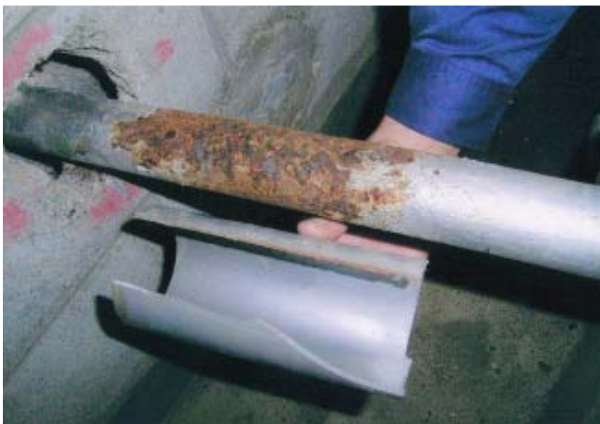
写真3 スリーブとの隙間で発生した外面腐食
