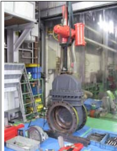
写真1 発災した電動仕切弁
