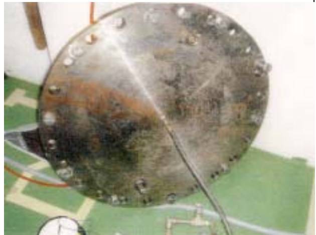
写真4 吹き飛んだフタ板(表側)
