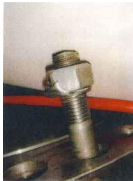
写真6 ボルト・ナットと破断した平座金
