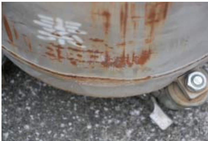
写真 周溶接部(下部)のへこみ状況
