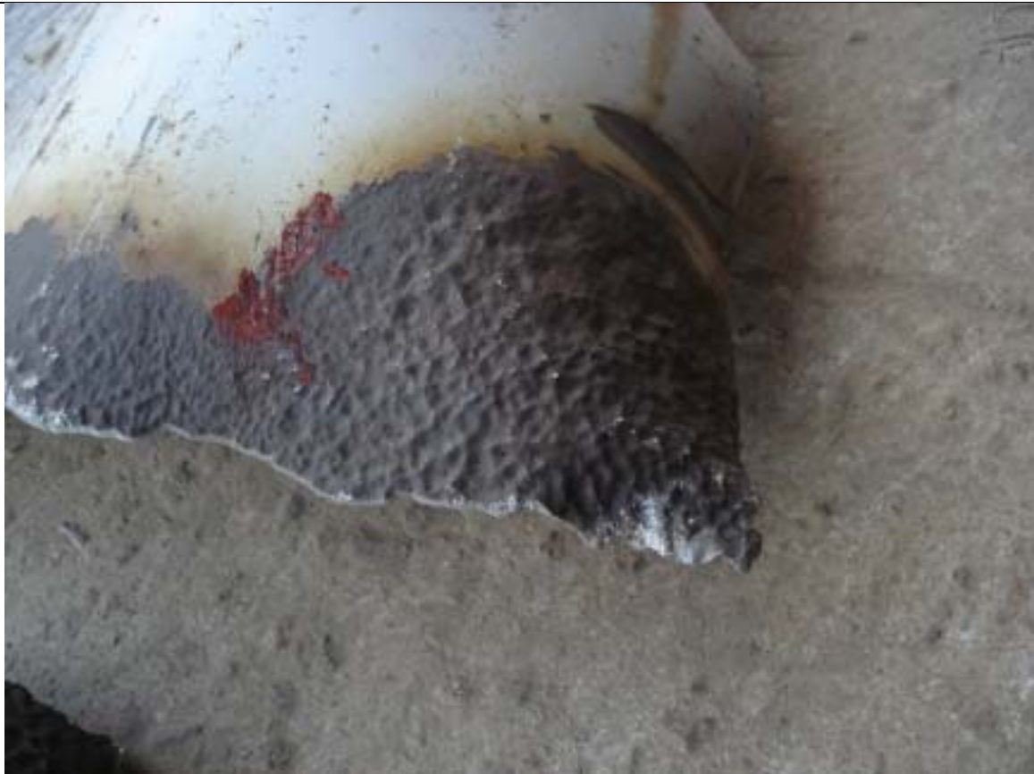
写真4 容器本体の腐食状況
