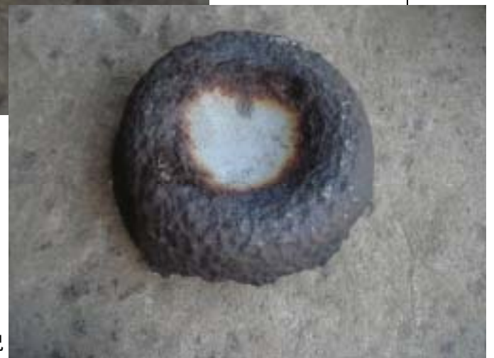
写真 3 底部(下側)の腐食状況
