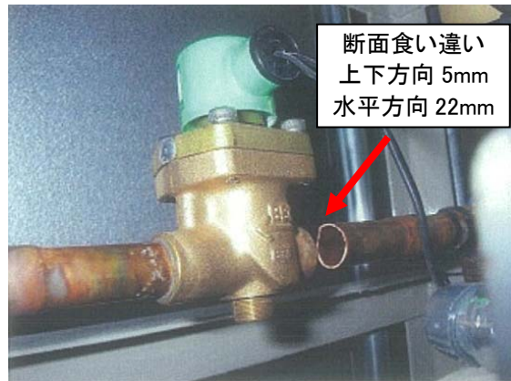
写真 1 ①電磁弁破断状況
