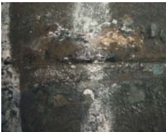
写真 5 実体顕微鏡による溶接部内面写真 (漏えい箇所 B)
