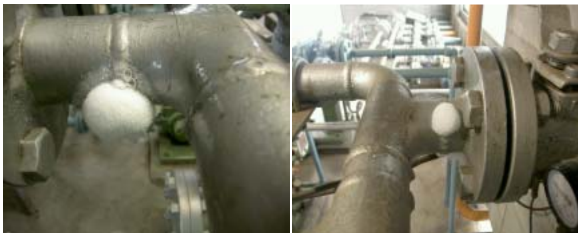
漏えい箇所A
