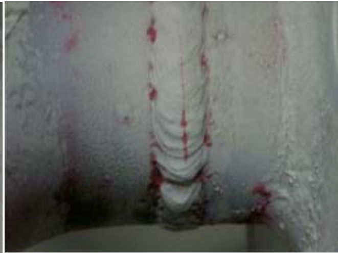
漏えい箇所 B 溶接部における割れ
