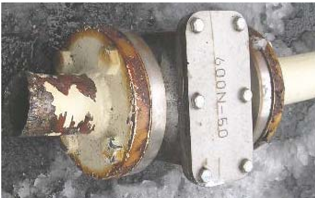
写真 3 落下直後の放散管(拡大写真)
