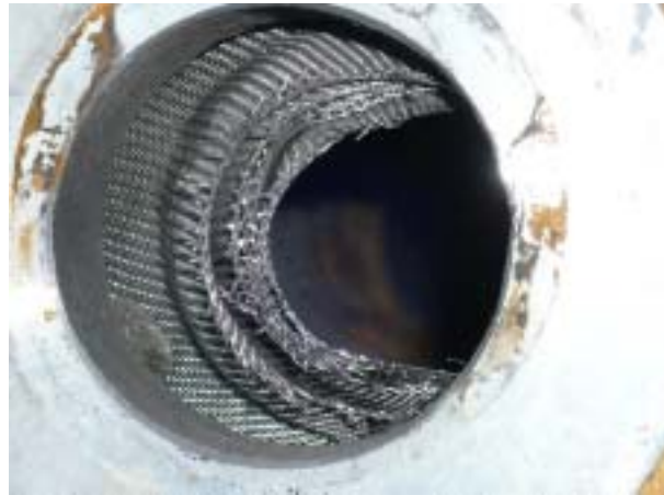
写真5 破損したフレームアレスター内部の金網の状況
