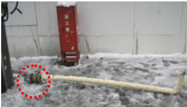
写真 1 落下直後の放散管
