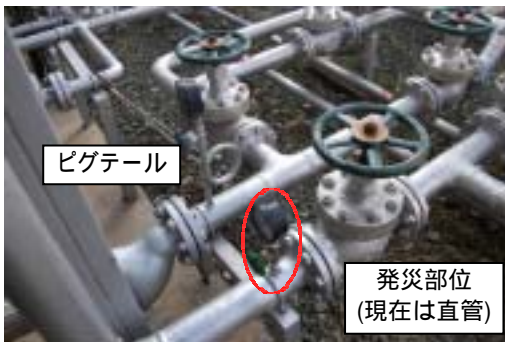
写真1 漏えい箇所(設備更新後)
