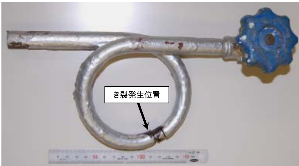
写真3 サイフォン管全体写真 (開口部付近は破面観察のため切断した後)
