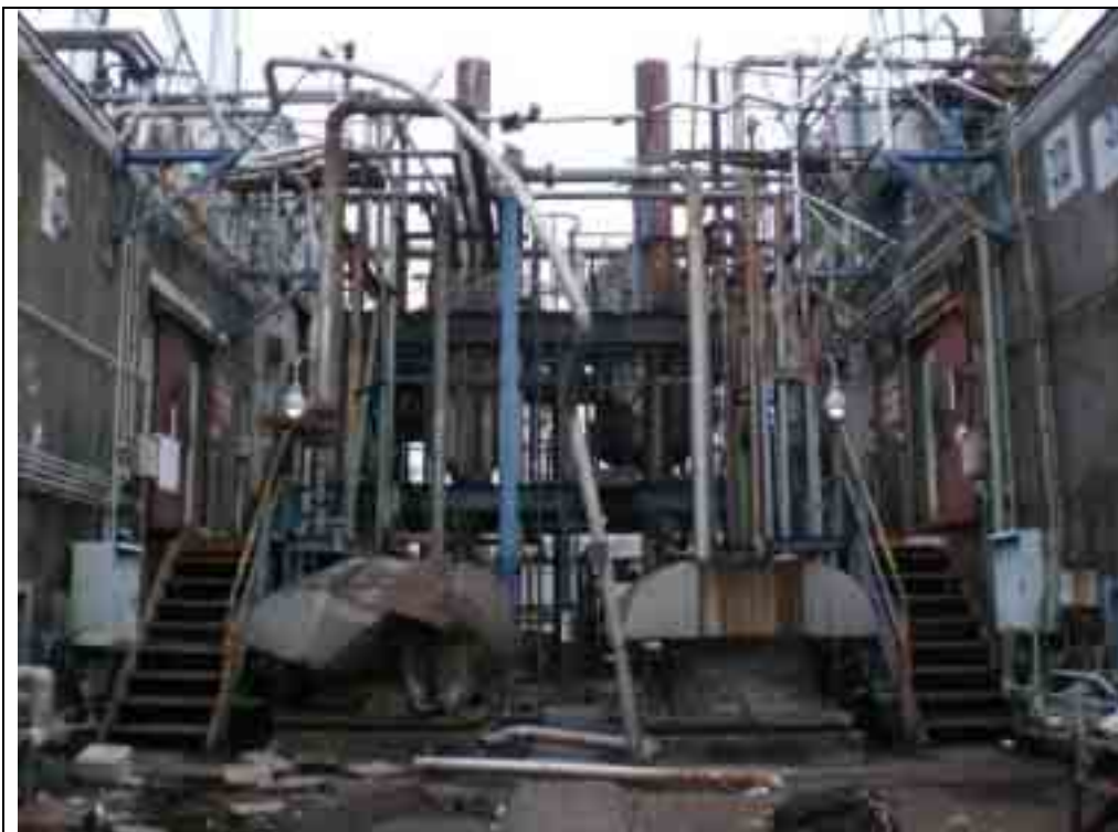
写真1 放出管落下の状況(グレイロック継手の開放作業は、右側の部屋で実施)
