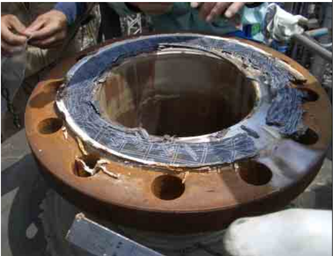
写真3 ガスケットの状況
