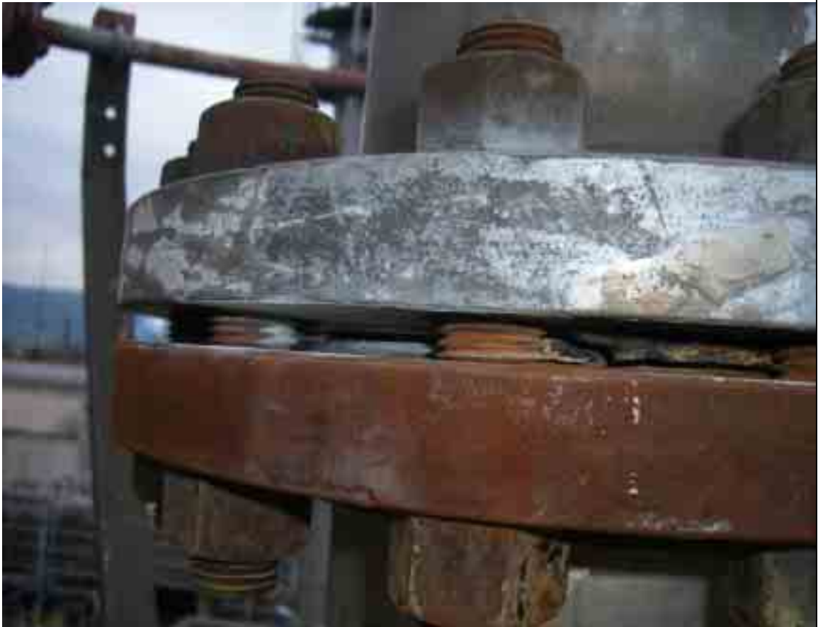
写真2 漏えいしたフランジ部
