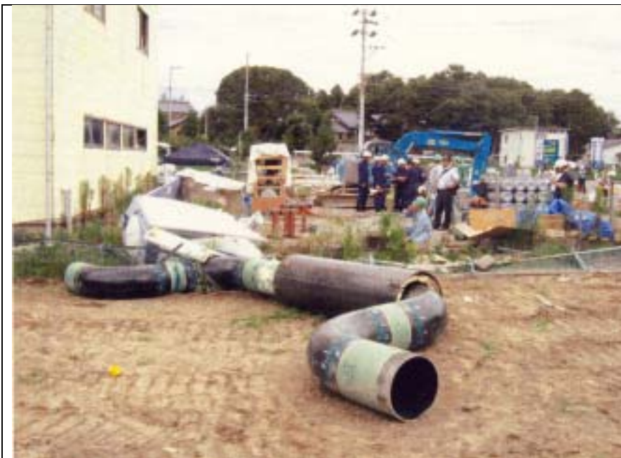
写真 1 事故時の状況(吹き飛んだ閉止板側)
