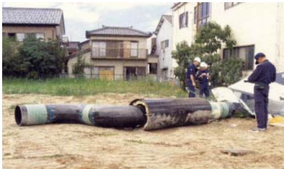
写真 2 事故時の状況(中央部がケース管)
