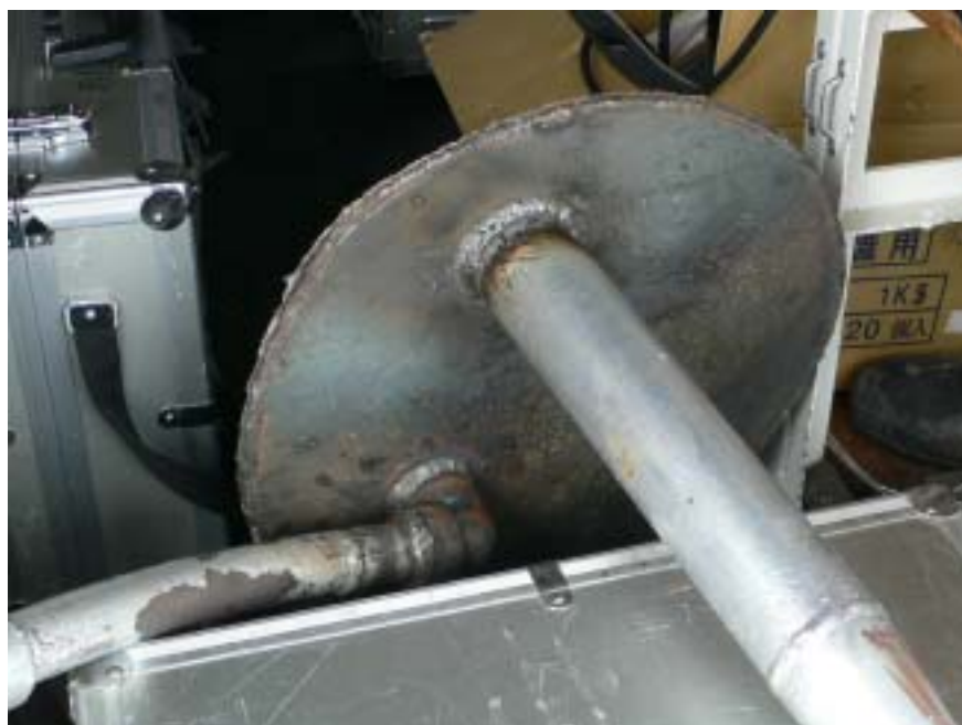
写真 3 吹き飛んだ閉止板(車両上に移設)
