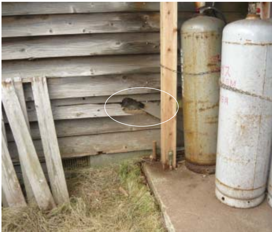
写真2 容器底部が突き刺さった跡(LP容器も底部が腐食)
