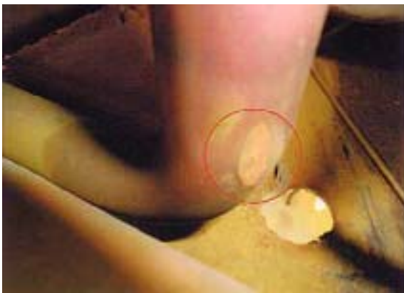
写真4 均圧配管が接していた 膨張弁出口配管
