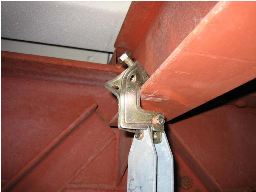
写真 3 変形した吊り金具
