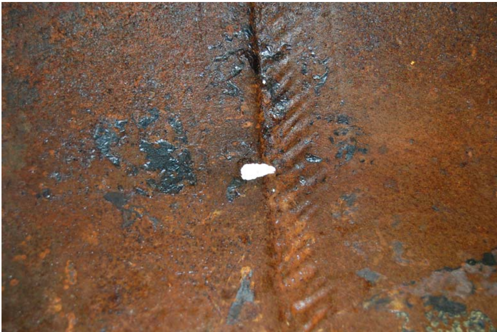
写真4 開口部の状況(→上側)
