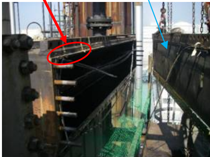
写真1 エアフィンクーラーヘッダー
