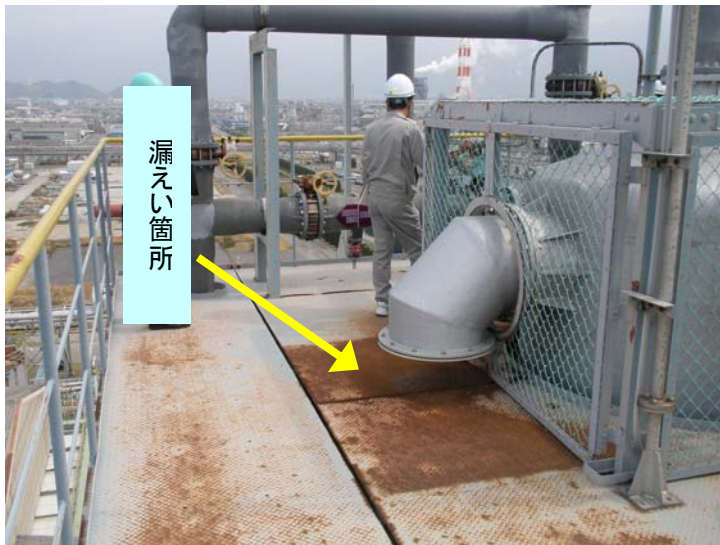
写真 3 漏えい箇所 (T-851 除害塔上部空気取入口)
