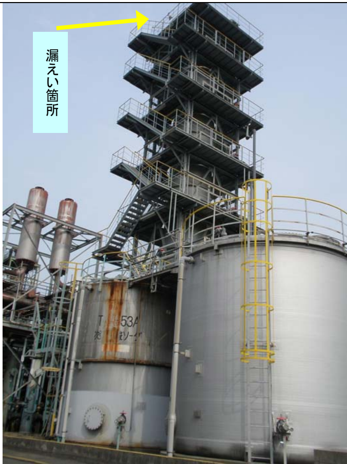
写真 2 漏えいのあった除害塔 (T-851 高さ約 27m)
