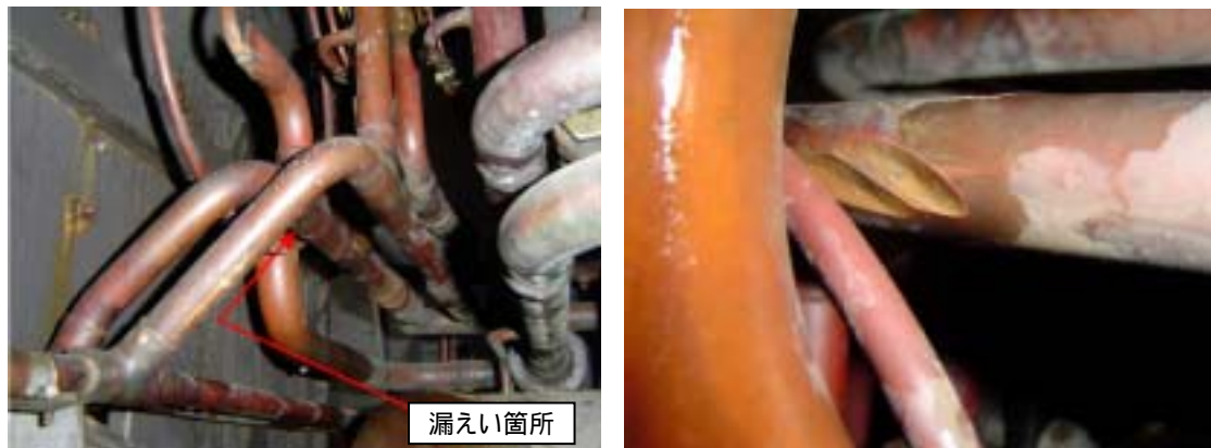
写真1 漏えい箇所外観
