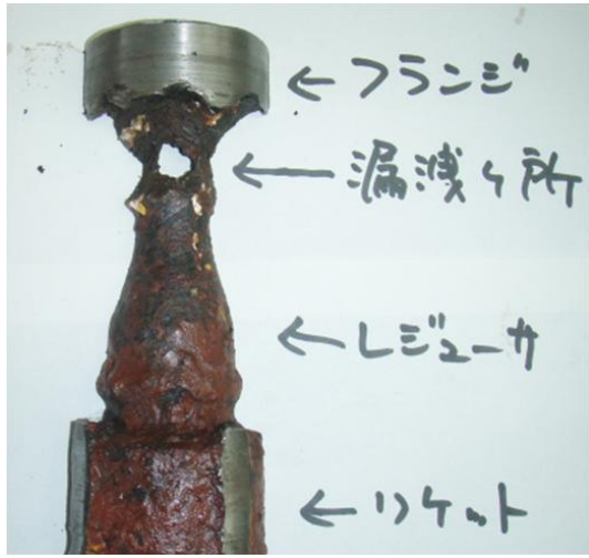
写真3 漏えいノズル
