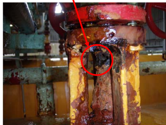
写真2 漏えい箇所拡大
