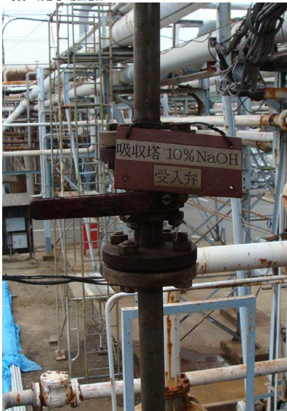
写真2 NaOH 受け入れ弁(手動弁)
