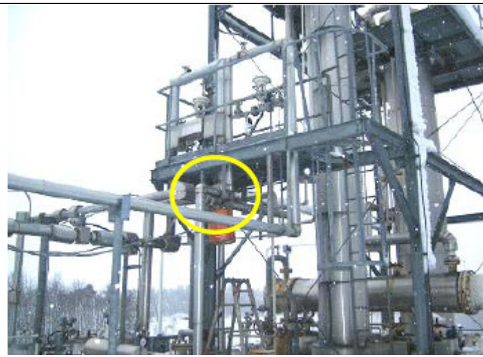
写真2 漏えい発生箇所状況(その1)
