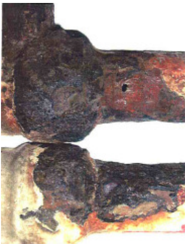
写真4 漏えい部の外観状況
