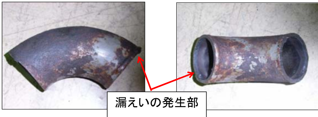
写真1 漏えい箇所(切除した漏えいエルボ)
