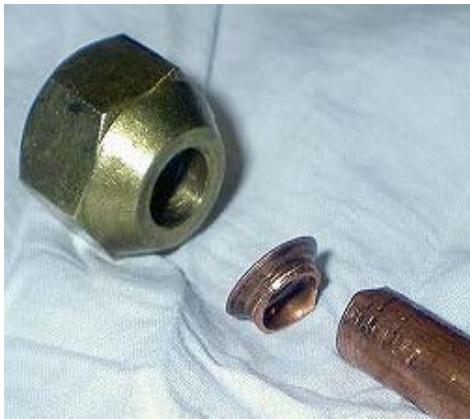
写真4 銅管の破断状況
