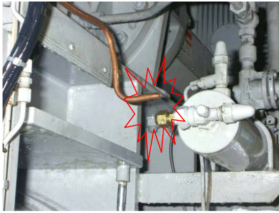
写真1 配管破断箇所 (破断位置が見えるよう、 配管をずらした後。)
