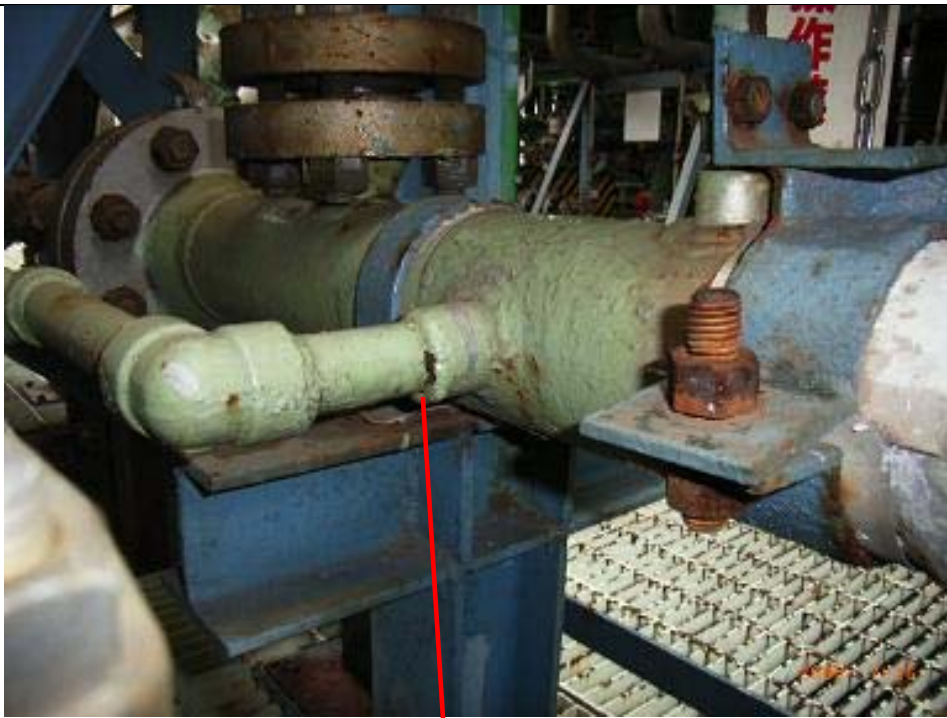
写真1 き裂部の状況
