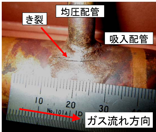
写真 1 き裂発生部位
