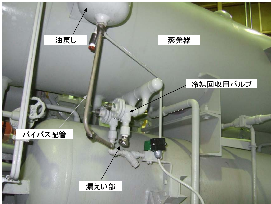
写真 1 漏えい部の状況
