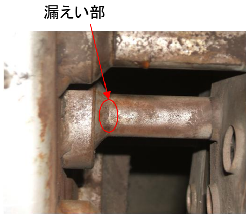
写真4 2段クーラー入口配管
