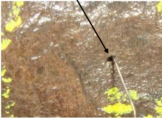
図5 漏えい箇所拡大
