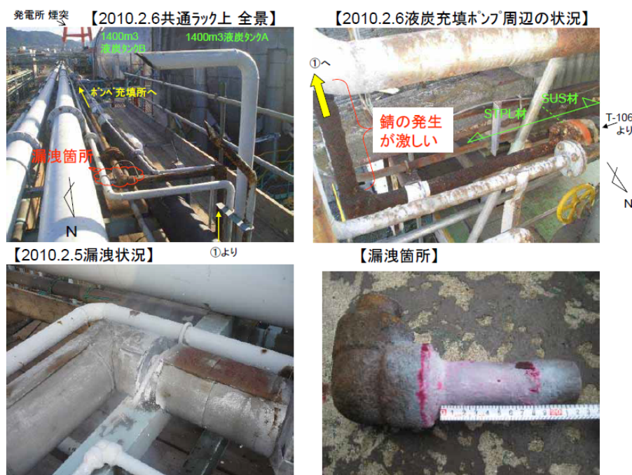
写真1 漏えい部周辺の状況
