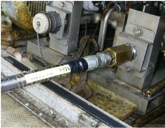
写真 3 発災後の耐圧ホース
