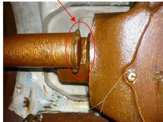
写真6 ピストンロッドの破断
