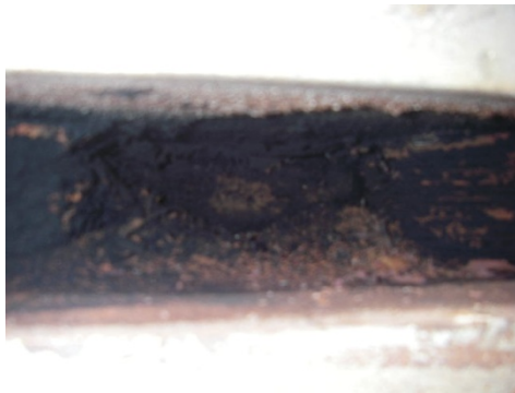
写真5 フランジ面間(南側)
