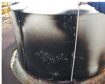
写真2フランジ(南側)
