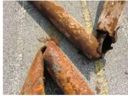
写真7 破断したブレース (交差部全体)
