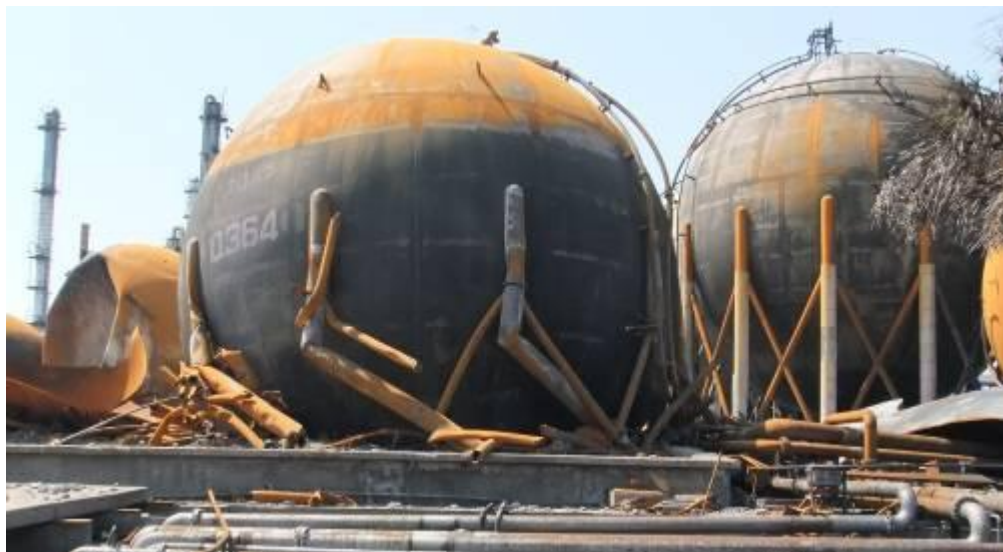
写真 1 倒壊した球形貯槽(事故後撮影)
