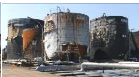
写真5 隣接するアスファルトタンクの損傷状況
