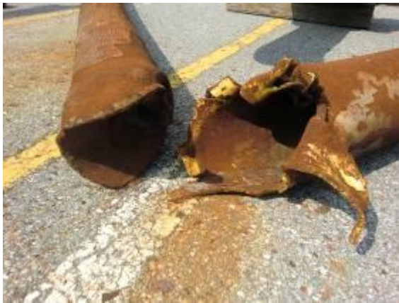
写真8 破断したブレース(溶接部)
