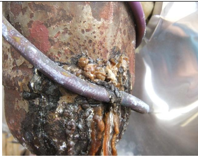
写真 1 スチームトレースと漏洩状況
