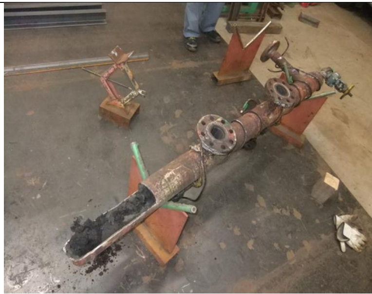
写真 4 連通管下部のスケールの状況
