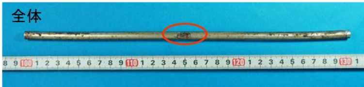
写真 3 圧力計用導圧管の漏洩部の状況
