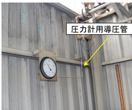
写真 2 充てん室に設置した圧力計
