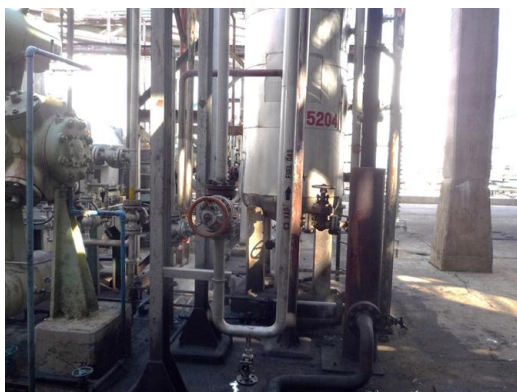
写真1 プロパン脱湿装置の切替ライン
