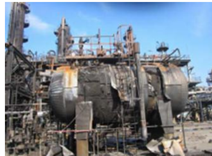
写真4 液塩酸一時受タンクの損傷状況
