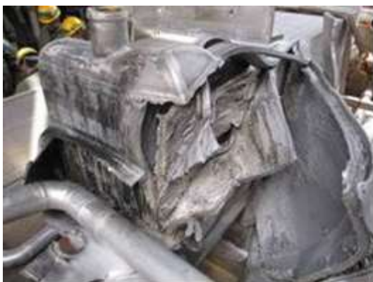
写真 3 熱交換損傷状況
