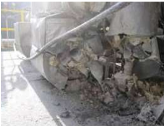
写真 1 調節弁周辺損傷状況
