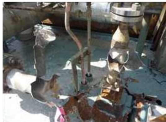
写真 2 調節弁周辺損傷状況(拡大)
